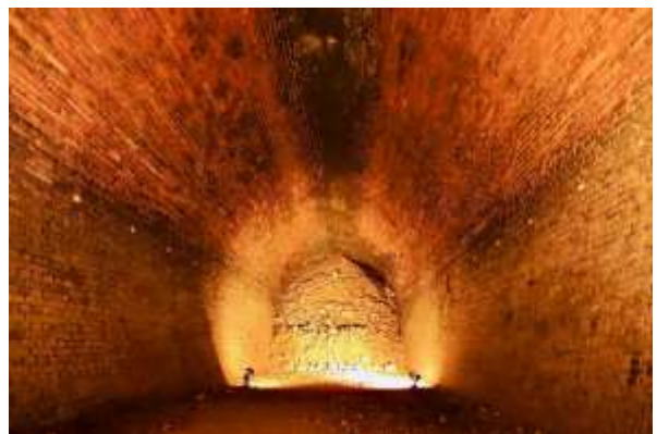
亀の瀬トンネルの崩落面
